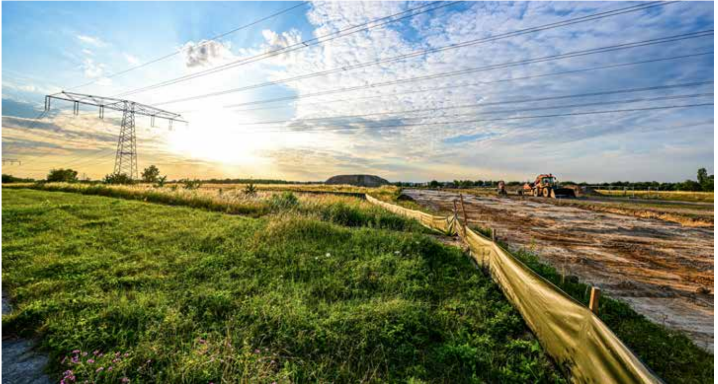
Blick auf die durch das Gebiet führende Hochspannungsleitung und den Bauarbeiten der Planstraße E
